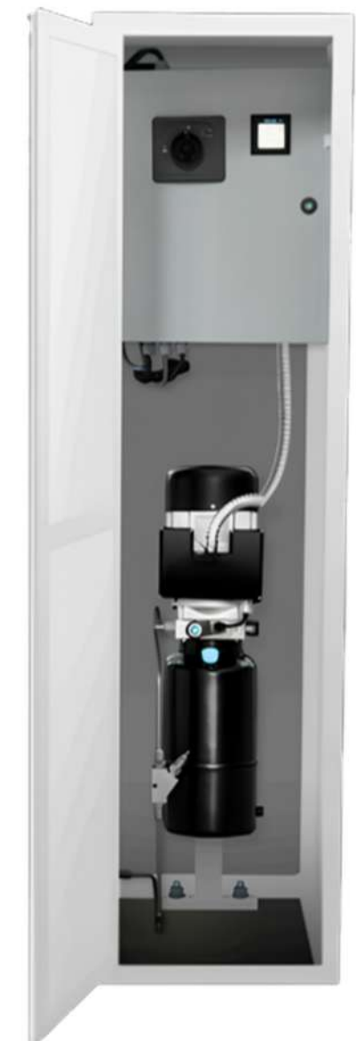
Gabinete de control.
